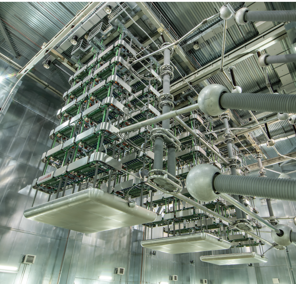
Sala tiristorских ventila konvertorskog postrojenja Kotor HVDC Kablovska interkonekcija Crna Gora – Italija (MON.ITA.)
